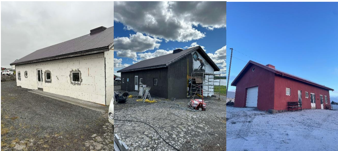
Mynd 2: Gamla sláturhúsið á Kópaskeri fyrir breytingar, á meðan á þeim stóð og lokaniðurstaða. Myndir: Jón Kristján Ólason
